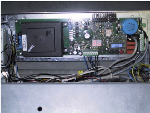
Ansicht der eingebauten Elektronik
